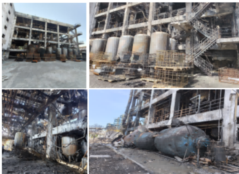
图 4 事故后现场照片
