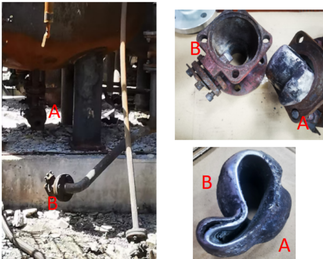
图 7 事故现场解体阀门图
